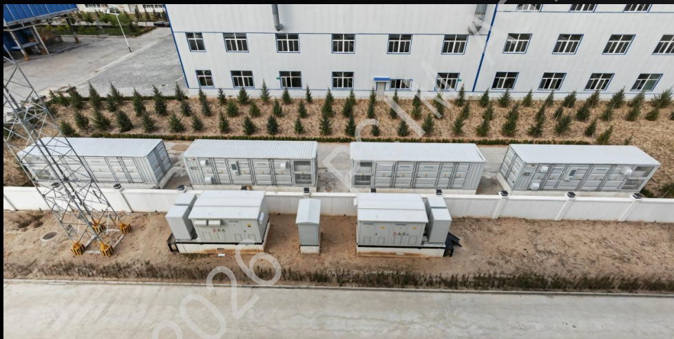
矿井备电5MW/20MWh储能系统
