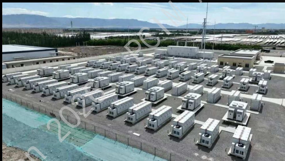
甘肃100MW/400MWh独立储能电站
