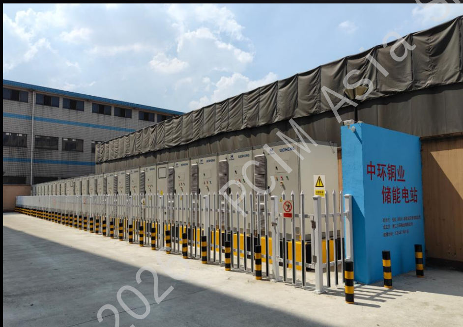
浙江2420kW/5126kWh储能系统
